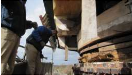
aantasting kruivloer en voeghoutkop
